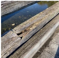
(図1) 腐食している高欄
