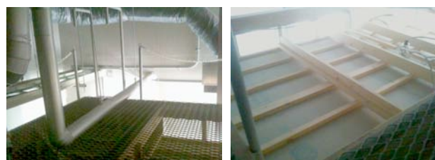
(a) 鉄製格子足場 (a) Scaffoldings (b) 天井裏を上から見た図 (b) Above the Ceiling
